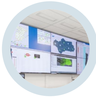
Plataformas de supervisión de redes de telecomunicaciones
